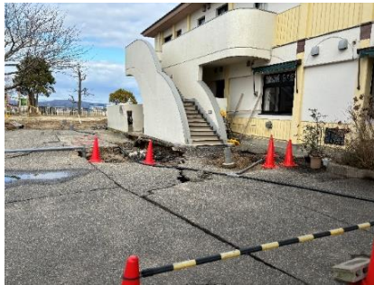
こども園は敷地が割れ、断水が続いていました
